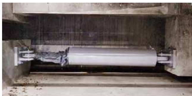
中央棟の地下に設置されている免震装置 (上：積層ゴム、下：オイルダンパー)
